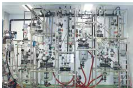
Технологические разводки / Трубопроводы подачи продукта
